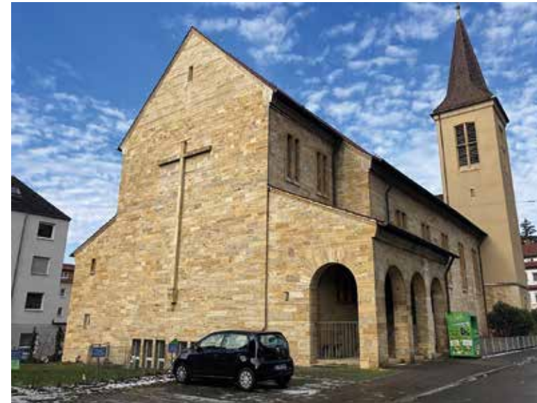
Die Natursteinfassade von St. Franziskus hat Risse und die Fugen sind teilweise ausgebrochen
